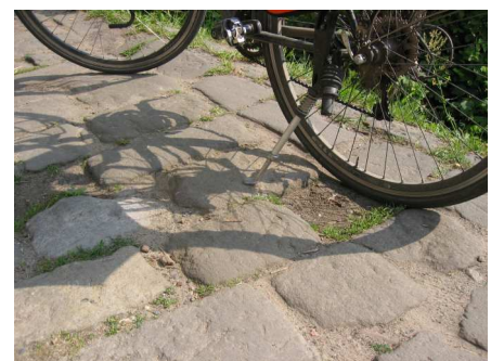
Deutliche Schäden im historischen Körnerweg
