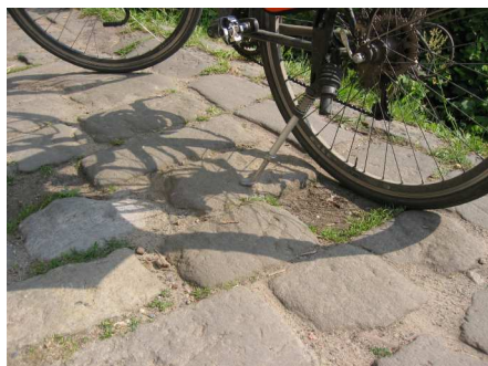
Deutliche Schäden im historischen Körnerweg
