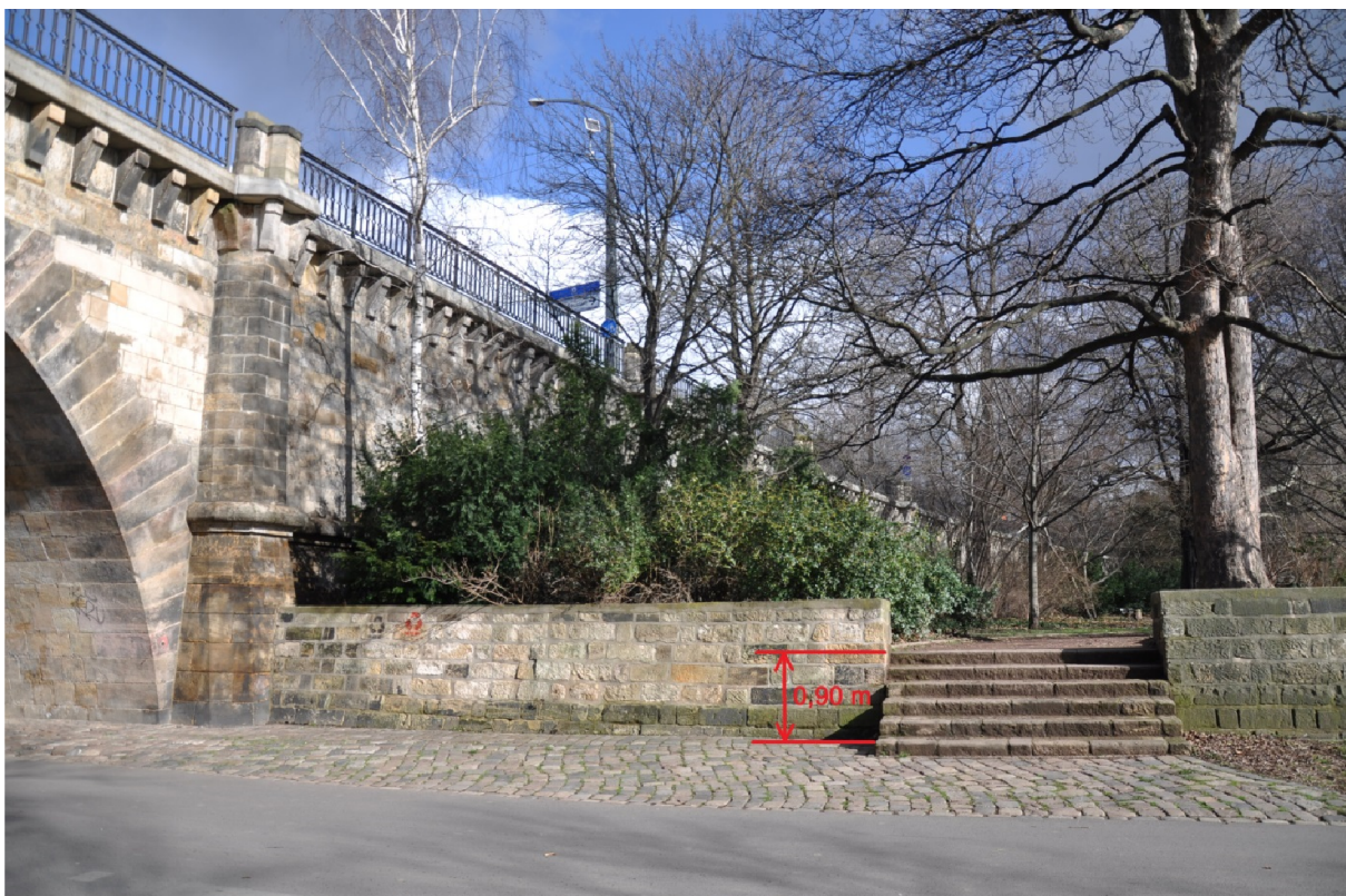
Höhenunterschied an der Treppe zwischen Elberadweg und Palaisgarten (0,90 m).
